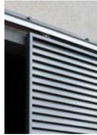
Schiebeladen Schiene sichtbar
